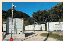
「群馬太田蓄電所」
